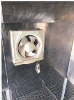
換気扇 (左奥側面)
